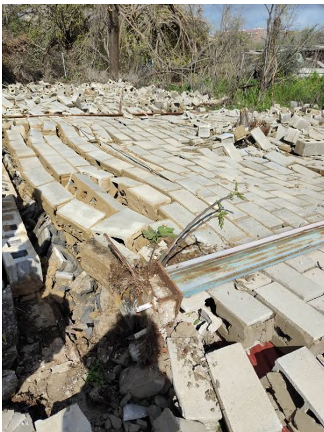
Muro de bloques de hormigón, rellenos y con estructura reforzada, derribado, categoría IF2.
